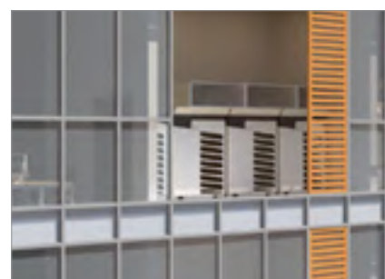
La unidad exterior está oculta dentro del edificio sin afectar a la imagen general del edificio
