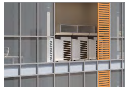
L'unité extérieure est escamotée à l'intérieur du bâtiment sans affecter l'image globale du bâtiment
